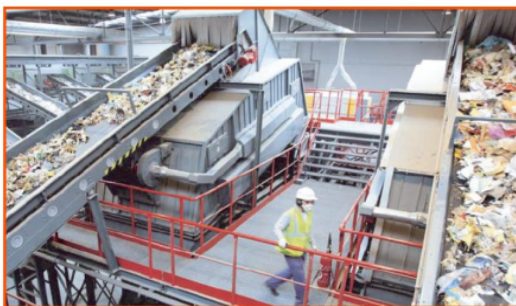
Figure 3 - Dans l'usine de Ludres, l'identification et le tri des déchets industriels banaux (DIB) sont entièrement automatisés.
